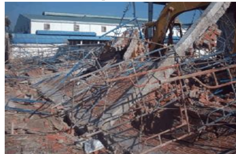
Sập tường rào ở Công ty Taisun KCN Tây Bắc Củ Chi (sự cố cấp II).
